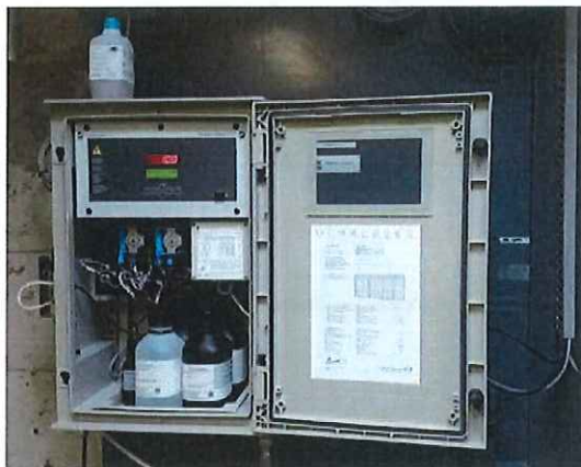
Fig.1: Installazione Stamolys CA71AL
